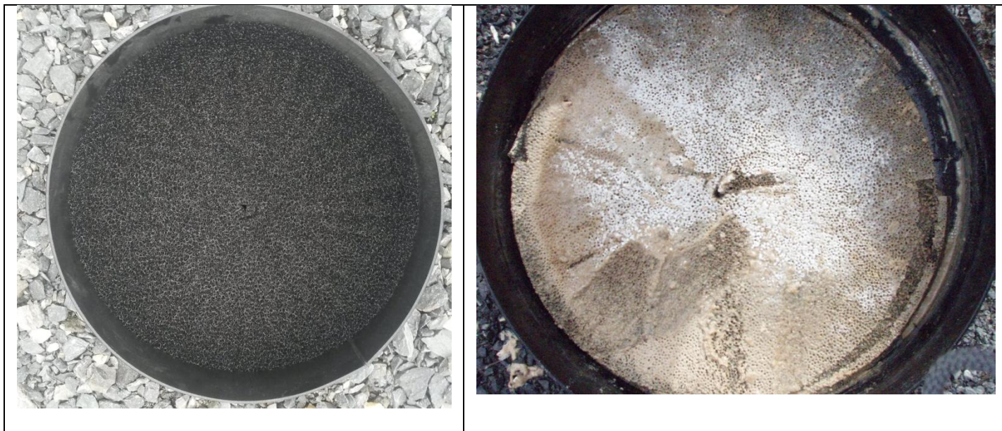
Kuva 8. Puhdas ja likainen rasvainen suodatin
